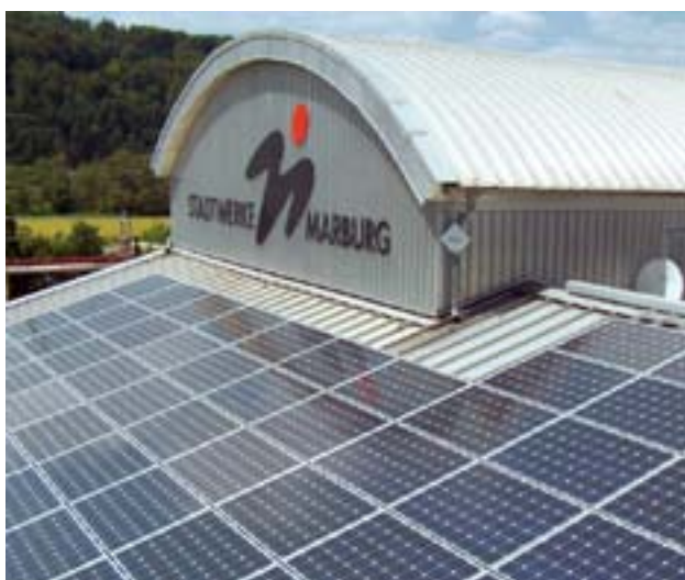
Die Stadtwerke haben eine neue PV-Anlage (rund 30 Kilowatt Peak) auf dem Dach der Hauptverwaltung installiert.
