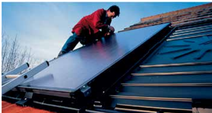
Kollektormontage auf einem Ziegeldach
