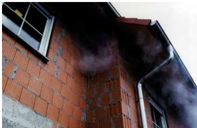
Einzelne Schwachstellen können Mithilfe eines Nebelgenerators optisch dargestellt werden.
